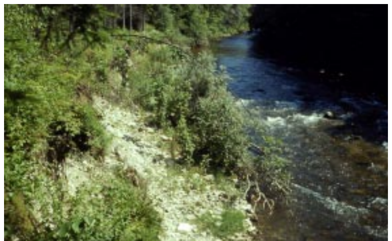
Bild 9: Detailansicht des Ufers der Wutach mit unterspülter Verbauung. Der Böschungsfuß besteht aus teilweise verkitteter älterer Alluvion der Wutach, in die sich der Fluss wieder eingetieft hat. (Foto: M. Jäggi)
