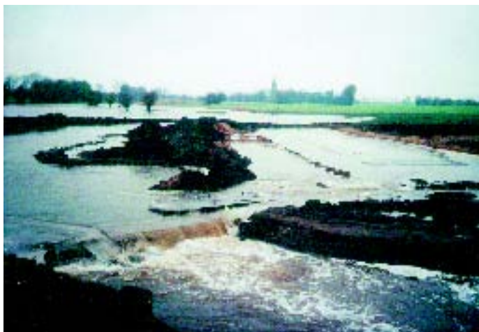
Bild 3: Hochwasserbedingte Überflutung der Baustelle am 19.11.2002 (Foto: R. Barz)
