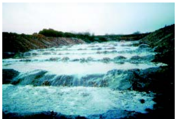
Bild 6: Die Probeflutung diente dem Erkennen von Schwachstellen (Foto: R. Barz)
