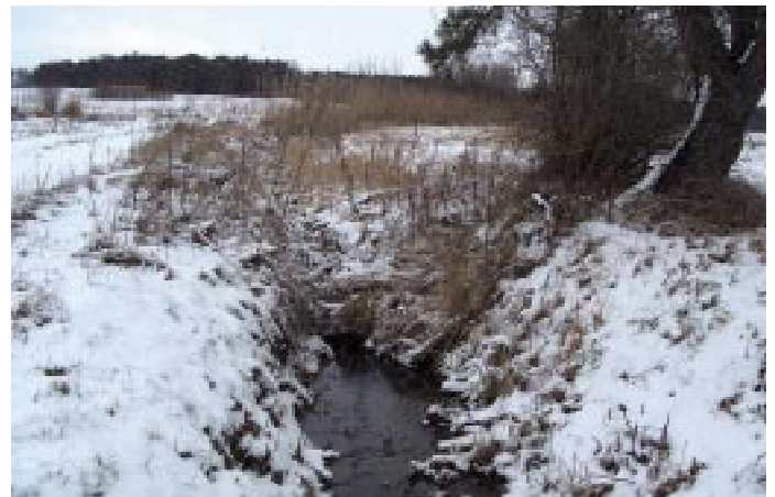
Bild 1: Blick auf den nicht geräumten oberstromigen Teilbereich des Bachl-Grabens.
