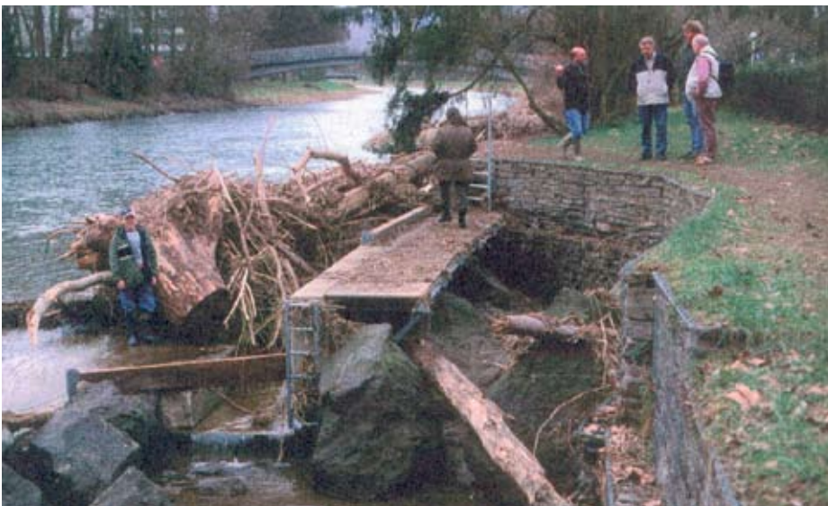
Bild 1: Meterhoch verkleuster Einlauf einer Fischaufstiegsanlage
