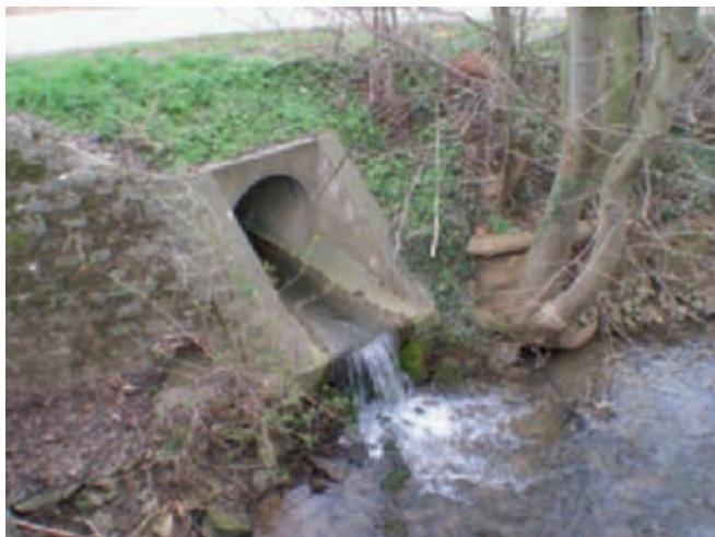
Bild 2: Durch die Sohleneintiefung der Pfrimm war Durchgängigkeit nicht mehr gewährleistet. Den Anforderungen der Wasser- rahmenrichtlinie (WRRL) konnte eine integrierte Planung, die mehrere Probleme gleichzeitig löst, am Ehesten gerecht werden. (Foto: A. Valentin)
