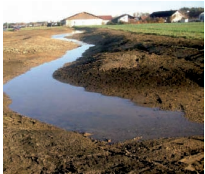
Bild 2: BA 02 unmittelbar nach der Renaturierung: Erstellt wurde nur das Rohplanum. Das Aushubmaterial wurde von den umliegenden Landwirten abgenommen.
