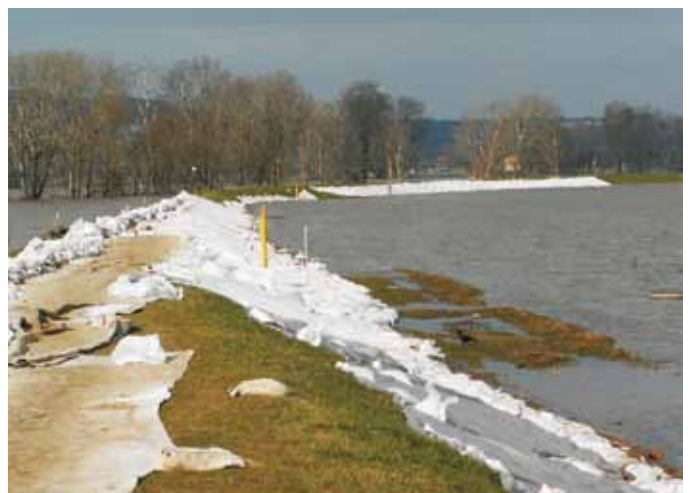
Abb. 3: Deichverteidigung beim Hochwasser 2006
