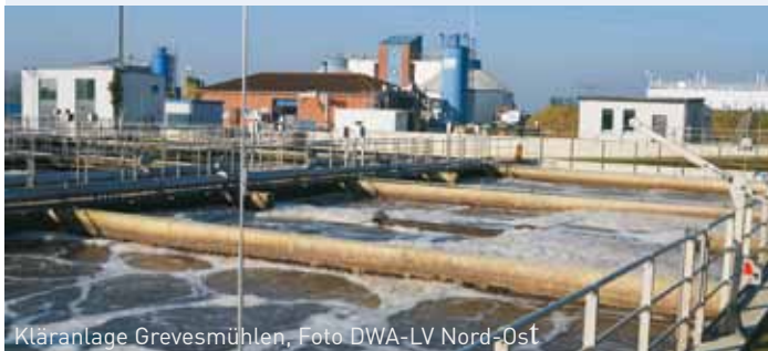
Kläranlage Grevesmühlen, Foto DWA-LV Nord-Ost
