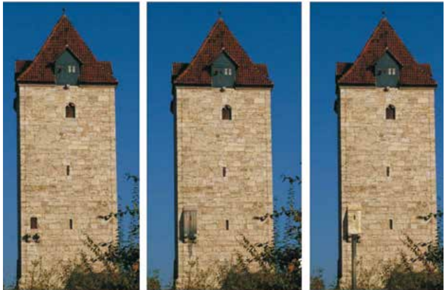
Abb. 3: Äußeres Frauentor, Südseite mit den Konsolen eines Abtritterkers, Computergrafische Darstellung des möglichen früheren Zustandes in Holz- und Steinbauweise, mit und ohne Fallschacht. (Quelle: Foto und Computergrafik: A. Bauer)
