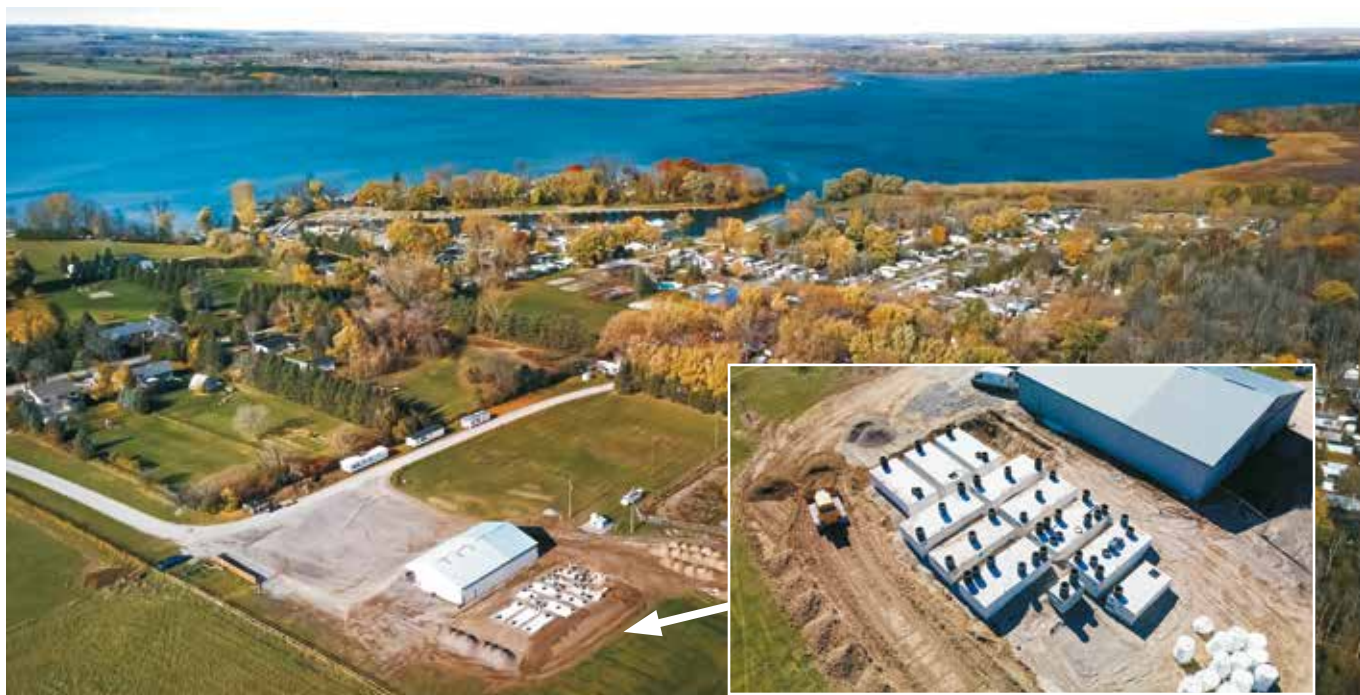
Abbildung 5: iQ.MBBR™ - Anlage für ein Campingresort am Lake Scugog, ausgelegt für eine Kapazität von 200m 3 /Tag. Die Reinigungsleistung der Anlage ermöglicht eine Direkteinleitung des gereinigten Abwassers in den See. (Fotos: Spark Photography)
