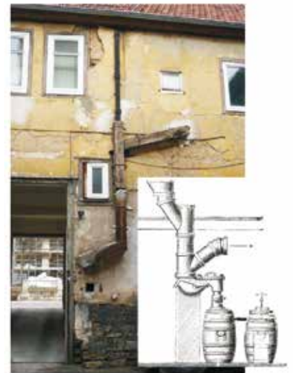
Abb. 7: Bei der Marienkirche 13 Abortfallleitung an der Außenwand des Vorderhauses im Innenhof bis zum Fäkaltonnenstandort; Foto: G. Laßmann
