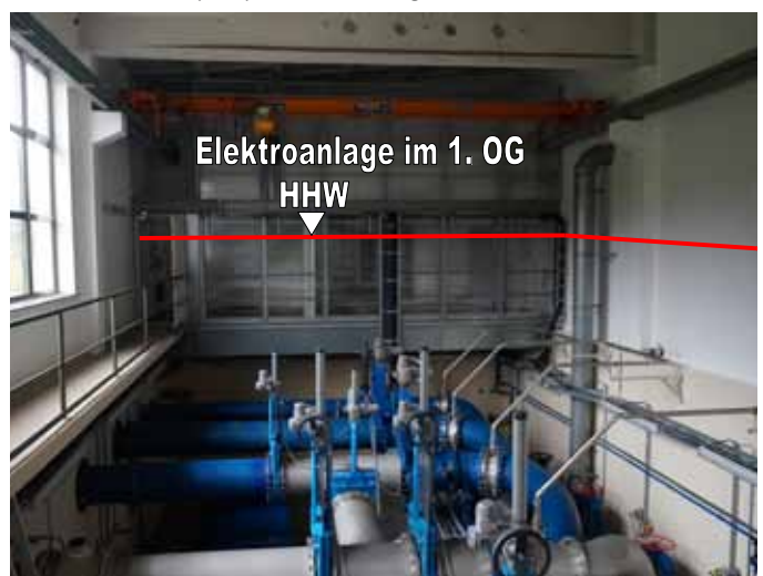
Abb. 5: Abwasserpumpwerk Kläranlage Zittau
