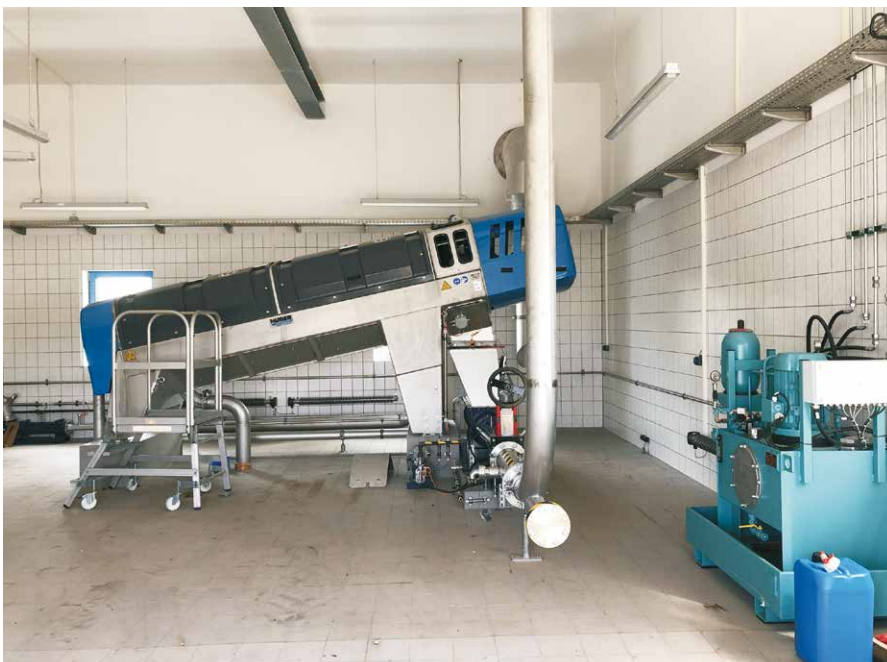
Abb. 2: MSE-Gebäude (Foto: Frank Mrasek, Huber SE)
