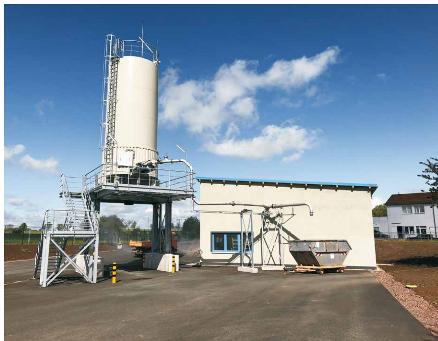
Abb. 3: Das unterfahrbare Klärschlamm-silo mit MSE-Gebäude (Foto: Frank Mrasek, Huber SE)
