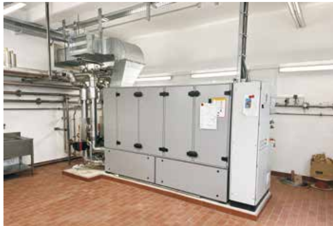
Abb. 3: Blockheizkraftwerk (BHKW) (Quelle: ZWA Saalfeld-Rudolstadt)
