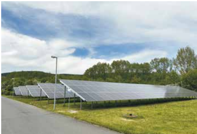
Abb. 2: Photovoltaikanlage (Quelle: ZWA Saalfeld-Rudolstadt)
