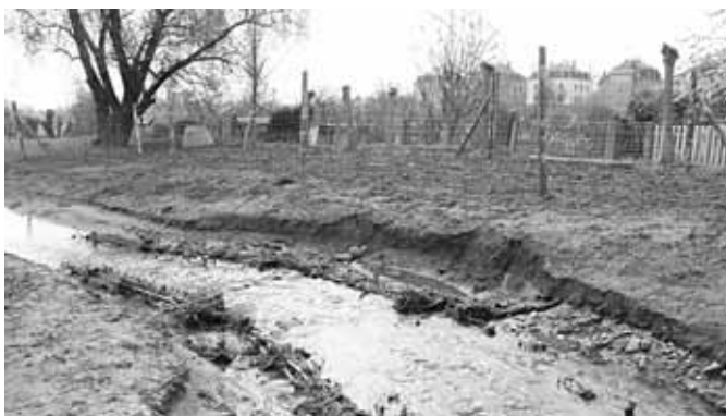
April 2006 – Schadbild: Auskolkung am Prallhang mit hinterspülter Faschine
