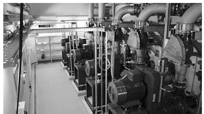
Bild 4: Maschinenraum des ZPW Heidenau
