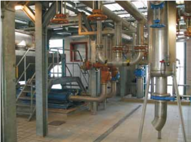
Abb. 3: Viele Rohrleitungen und Aussteifungen unter der Bühne
