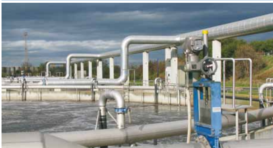
Belebungsbecken des Klärwerks Erfurt-Kühnhausen (Hans Uwe Küpper, Pöyry Deutschland GmbH, Erfurt)
