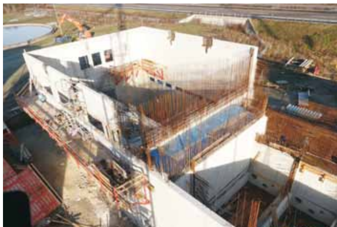
Abb. 4: Filteranlage mit Maschinenhalle; im Hintergrund: alte Nachklärung und BAB 71
