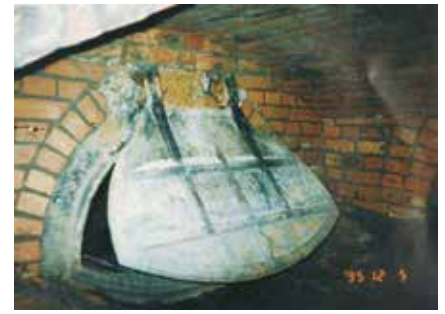
Abb. 2: Notüberlauf vom Wilhelmskanal in die Unstrut (Maulprofil mit Rückstauklappe) (Foto: G. Laßmann)
