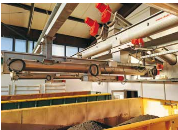
Abb. 7: Schlammverteilung im Container (Foto: AFRY Deutschland GmbH)
