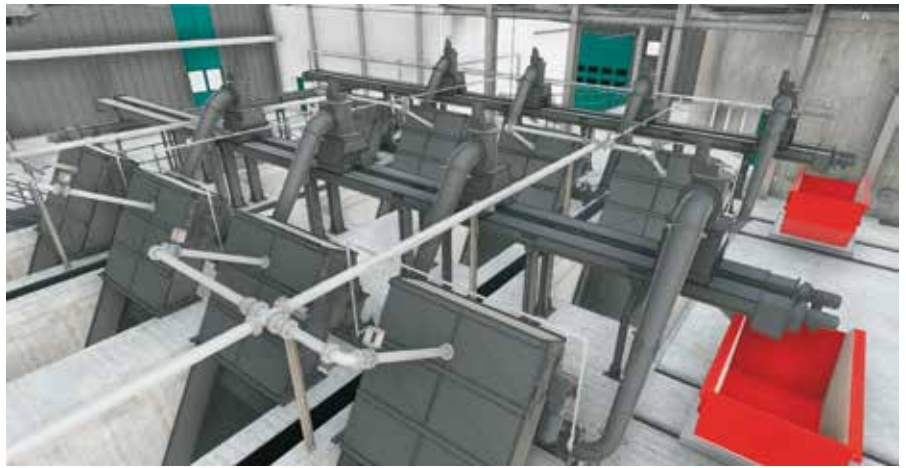
Abb. 4: Innenansicht des Rechengebäudes mit den hintereinander angeordneten Rechen je Rechenstraße, (Quelle: Entsorgungsbetrieb der Stadt Chemnitz (ESC))
