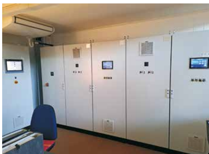
Abb. 8: Erneuerte Schaltwarte (Foto: AFRY Deutschland GmbH)
