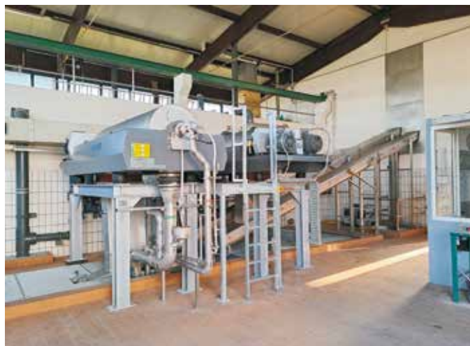
Abb. 4: Bühne mit Entwässerungszentrifugen (Foto: AFRY Deutschland GmbH)
