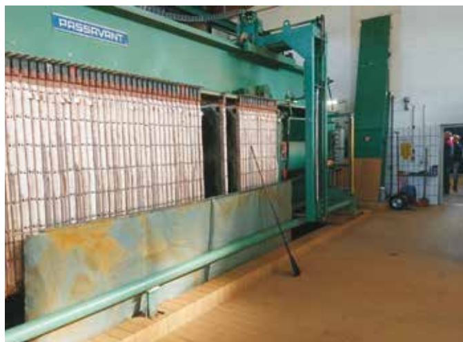
Abb. 2: Alte Kammerfilterpresse (Foto: AFRY Deutschland GmbH)
