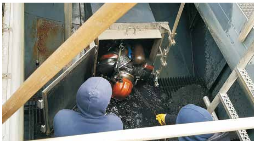
Abb. 2: Seitlicher Schlammabzug (Quelle: SOWAG mbH Zittau)
